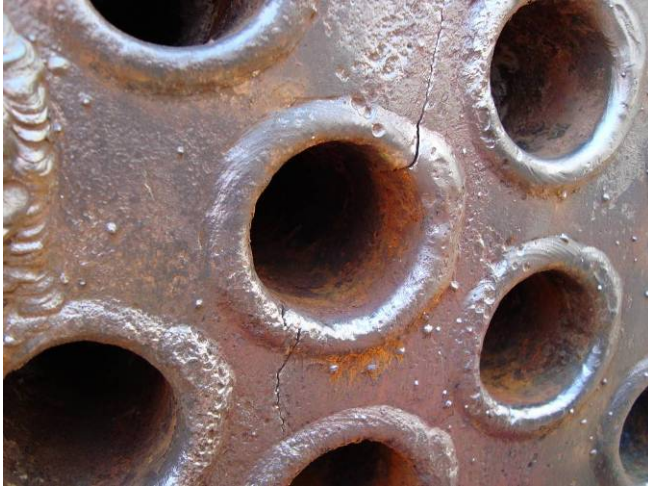
Pukotina na mostiću i zavaru
