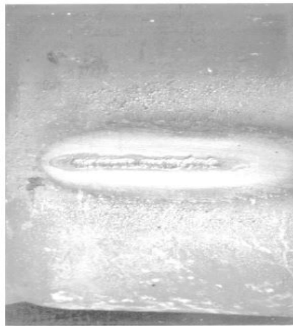
Oštećenje od zavara
