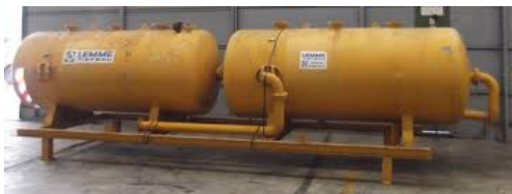
Horizontalni spremnici stlačenog zraka
